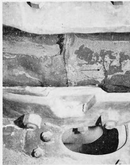
図38 裏面部分写真 矢印で示した亀裂は図36参 照。
